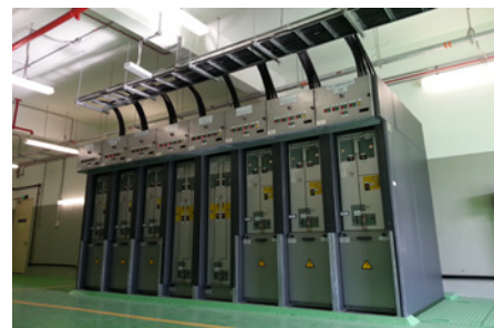
Centre de traitement des données Cyberjaya (Kuala Lumpur, Malaisie)
