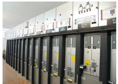
Spanische Energieversorger- Umspann- und Schaltstation (Spanien)
