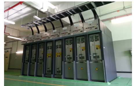
Google data center (Kuala Lumpur, Malaysia)
